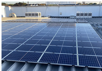
リベラ平塚発電所 (神奈川県平塚市)
