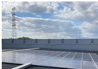
リベラ京田辺発電所 (京都府京田辺市)
