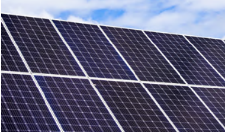
再生可能エネルギー設備の設置 (太陽光発電)
